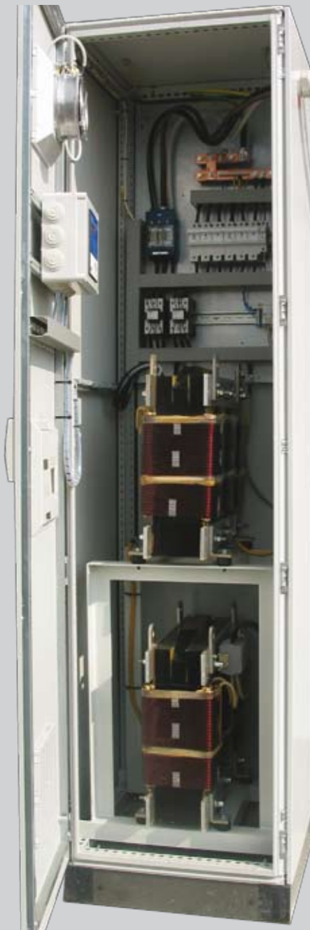
Pohled na dekompenzační pole 80 kvar
